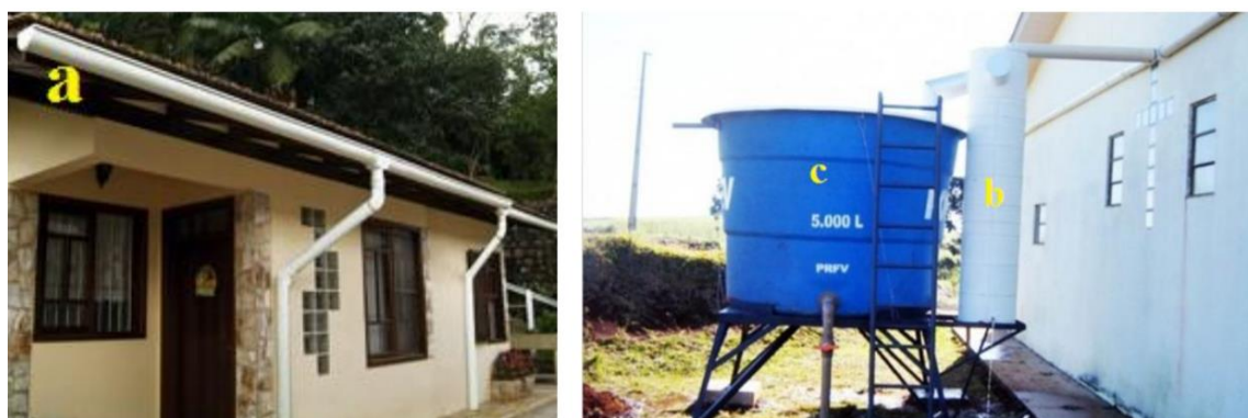
Figura 26 – Exemplo de sistema de captação da água da chuva.
