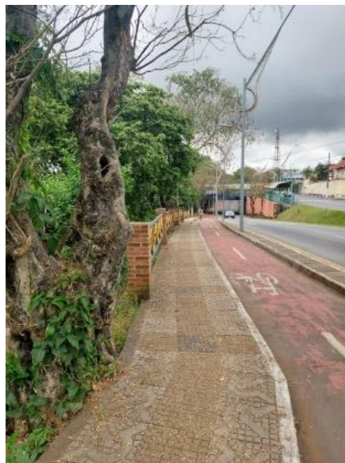
Trecho 02 – O concreto, o asfalto e o piso em cimento com base sólida em concreto denotam a inadequação da materialidade utilizada em áreas alagáveis.
